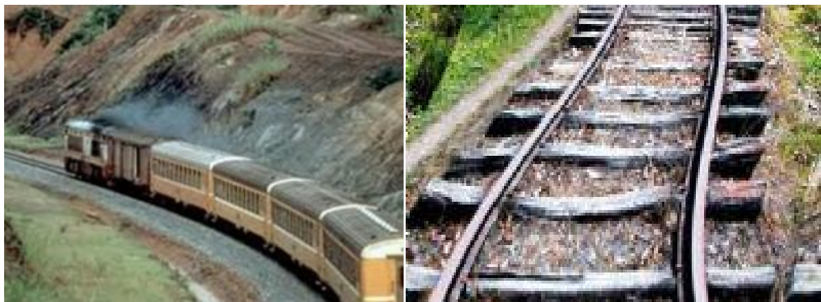
Photo 5 : rails en mauvais état et une locomotive
